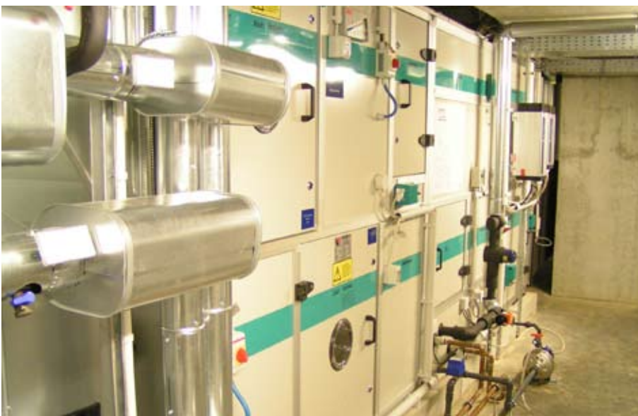
Klimaanlage mit adiabater Abluftkühlung über Regenwassernutzung
