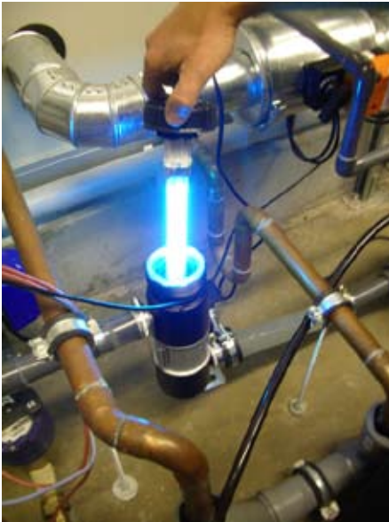
UV-Desinfektion des Betriebswassers
