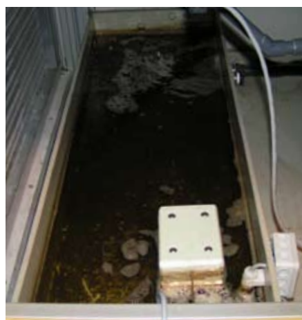
Wanne mit Betriebswasser, über die die adiabate Abluftkühlung zirkuliert, Nachspeiseventil mit mechanischem Schwimmer im Vordergrund, Leitfähigkeitsmessung in der Druckleitung im Hintergrund
