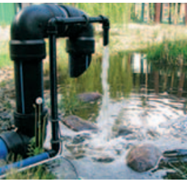
Überleitung von Regenwasser aus den Zisternen
